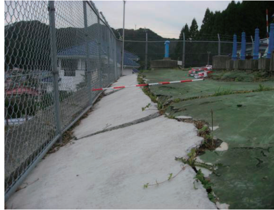
場内地盤沈下
