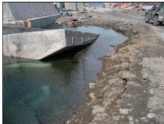
安渡3丁目 護岸倒壊による配水管被災
