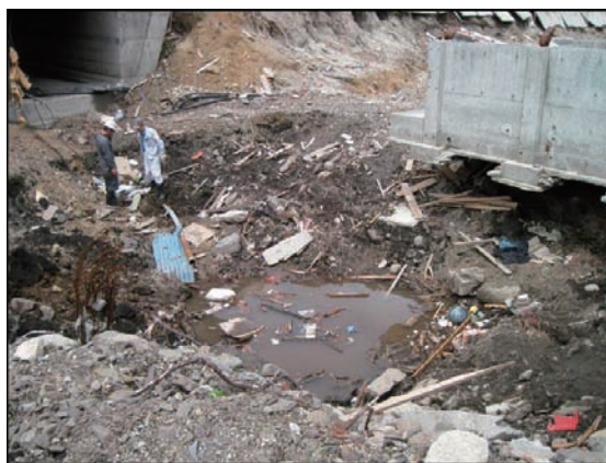
波板海岸配水管 管路埋設箇所陥没状況
