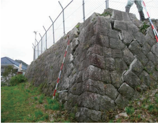
石積の一部損壊
