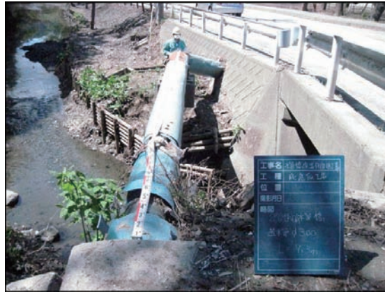
源水水管橋 保温材損傷送水管 \phi 300 L=9.30m
