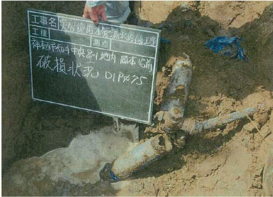
写真 2.19 サドル分水栓破損状況（茨城県神栖市）
