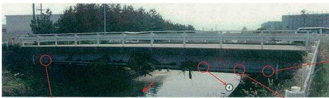
写真 2.21 水管橋(橋梁添架管)の被害状況(宮城県岩沼市)
