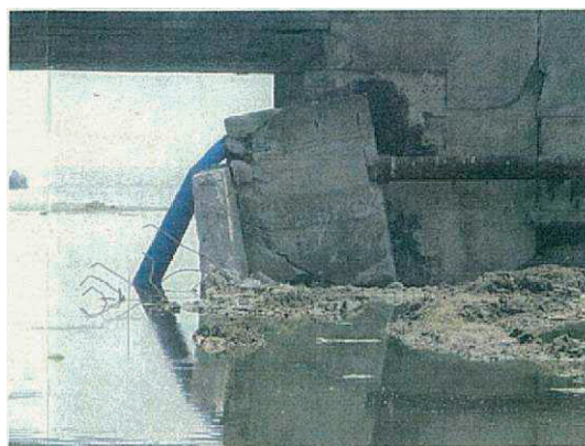
写真 2.22 水管橋(橋梁添架管)の被害状況(福島県いわき市)
