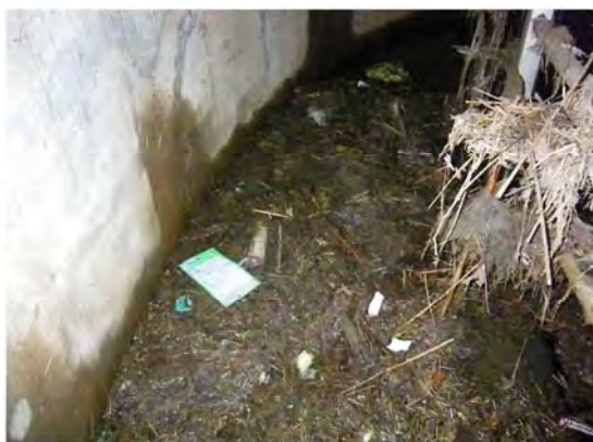
写真 3.4 浅井戸の津波被災例（岩手県陸前高田市竹駒第1水源地）
