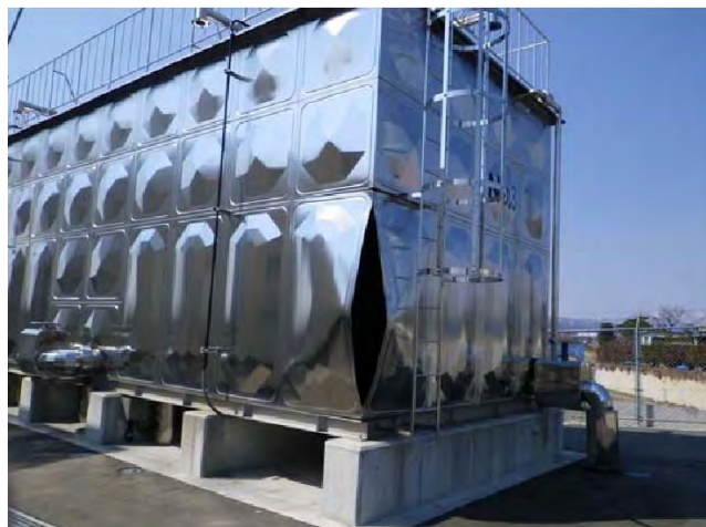
写真 3.2 ステンレスパネル配水池の被災例（福島県郡山市新池下ポンプ場）
