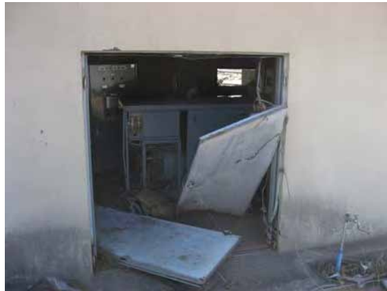
写真 3.6 津波による建具損壊状況（岩手県大槌町浪板ポンプ場）
