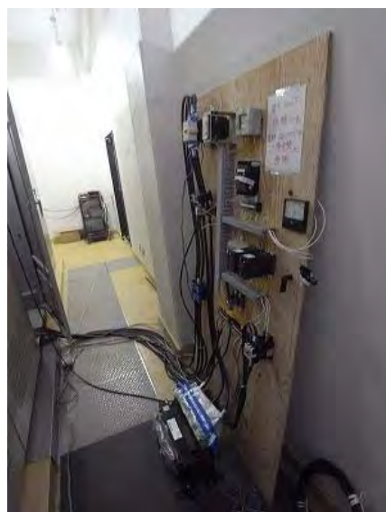
写真 3.7 津波被害後の仮設動力盤の設置例（岩手県山田町折笠第1水源地）
