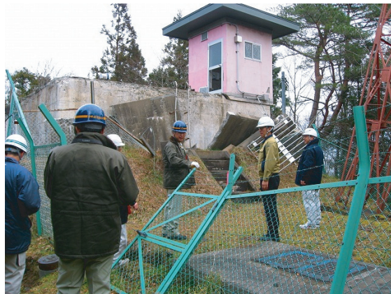
写真 5.6 小豆畑配水池被害状況
