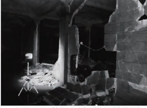
4・11の震災で被災した大高調整池の内部整流壁
