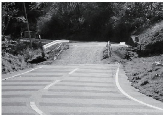
4・11の井戸沢断層で隆起した県道
