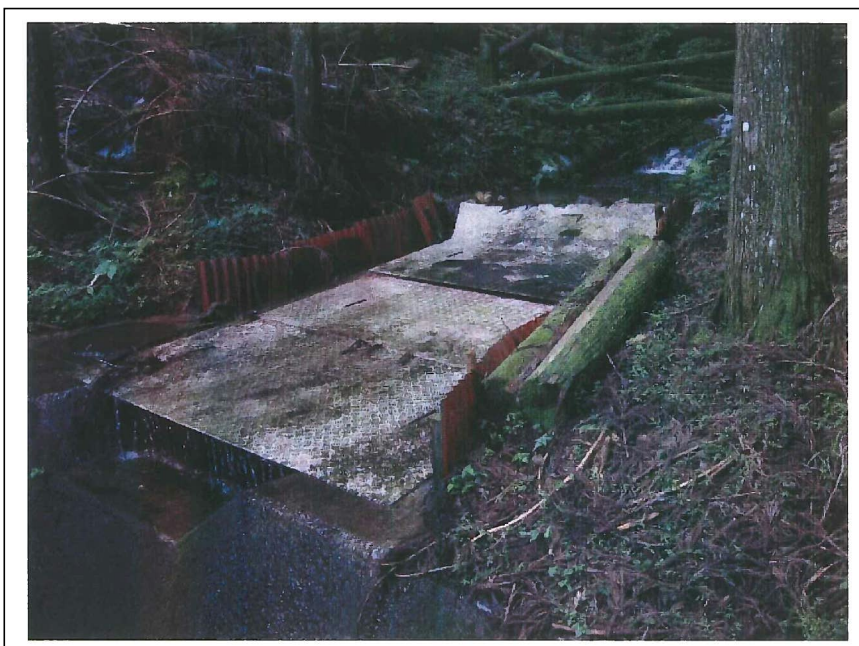
写真 3 f 地区取水施設
