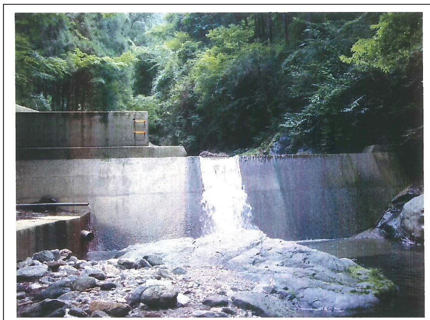
写真4 | 地区取水施設
