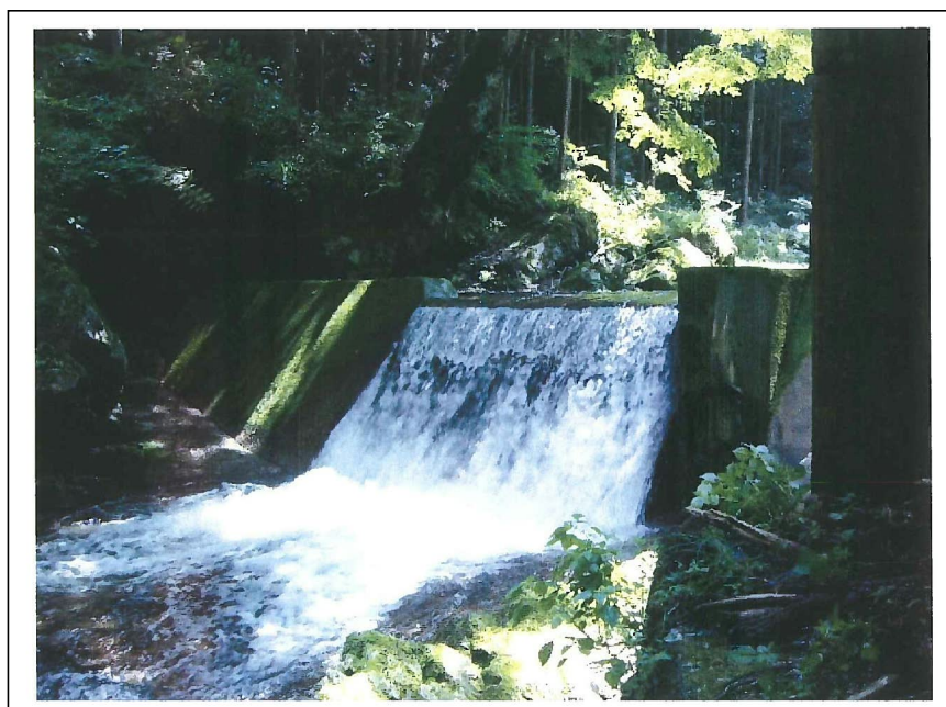
写真1 d地区取水施設
