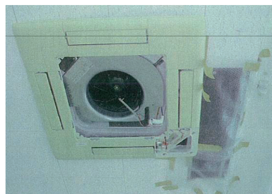
空調設備吹出口（3階会議室）の破損
