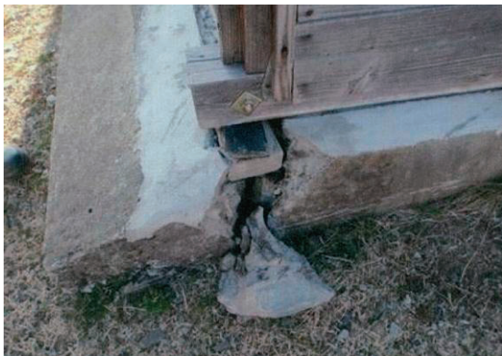
基礎コンクリート破損
