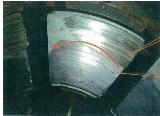
4号取水ポンプ下部スラスト軸受用パッドの 摩耗
