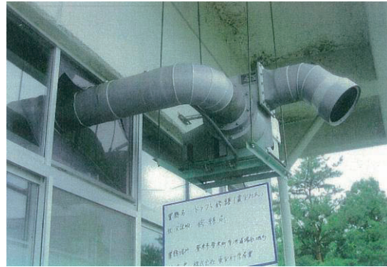
排気ファン地震動で破損
