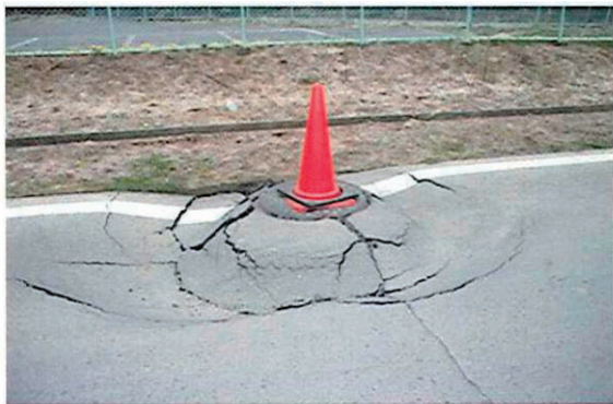
市内のいたるところで、路面の沈下によるマンホールの隆起や亀裂が発生
