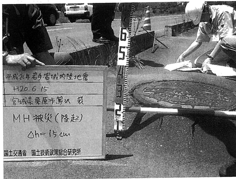
栗原市の鶯沢地区でマンホールが浮上（写真提供＝国土技術政策総合研究所）
