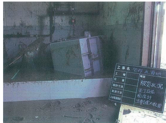
損壊した次亜注入設備（津波で貯蔵槽が転倒している）
