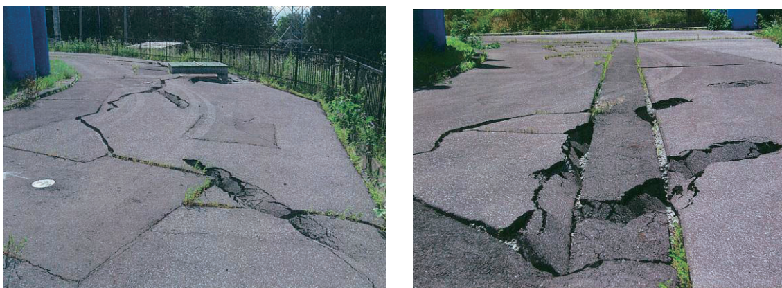
写真 4.1 高田配水池 法面崩壊による被災状況
