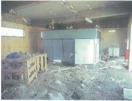
自家発の破損状況と流入した異物
