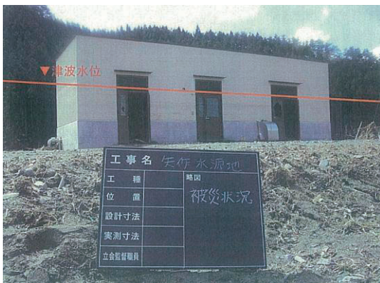
被災した水源地（浅井戸）全景（津波で建物が冠水した）
