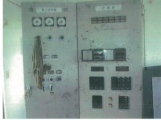
盤類の破損状況
