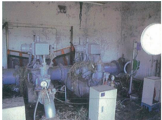
取水施設1階のポンプ室内部（津波による浸水で異物が流入した）
