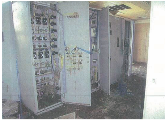
配電盤の破損状況
