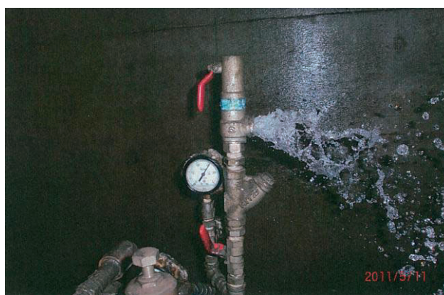
写真 4.2 配水管減圧弁からの漏水状況
