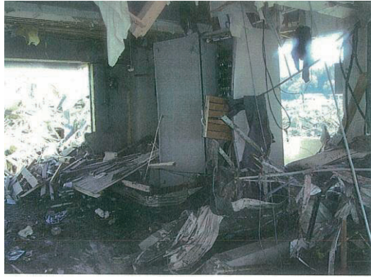
庁舎1階の監視装置が津波で損壊した
