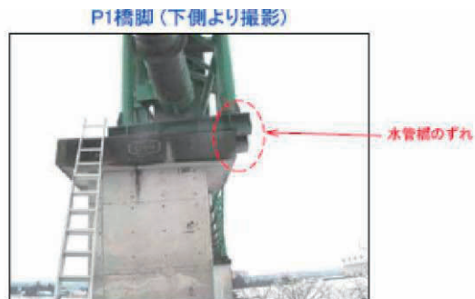
支承損傷によるずれ
