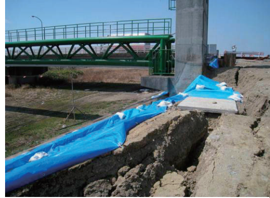
橋脚周辺の地盤滑りによる伸縮可撓 継手からの漏水
