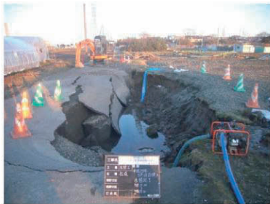
継手漏水(仙台市泉区松森地内 DIP φ900 K形)
