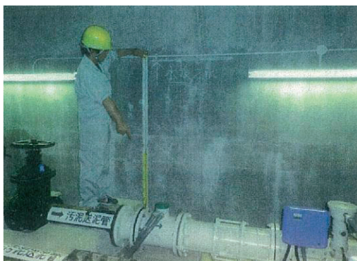
濃縮槽引抜汚泥流量計（電磁式 200A）
