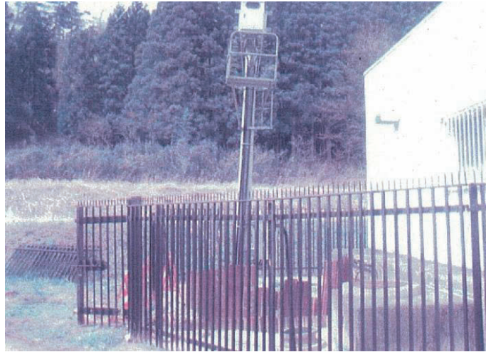
電気防食設備（引込柱・直流電源装置・ケーブル類は、地震動及び地震動に伴う地盤沈下により沈下・傾斜・破損）
