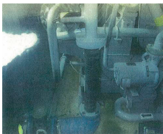
発電機冷却水戻り配管折損（中央黒 色立管(PVC65A)）
