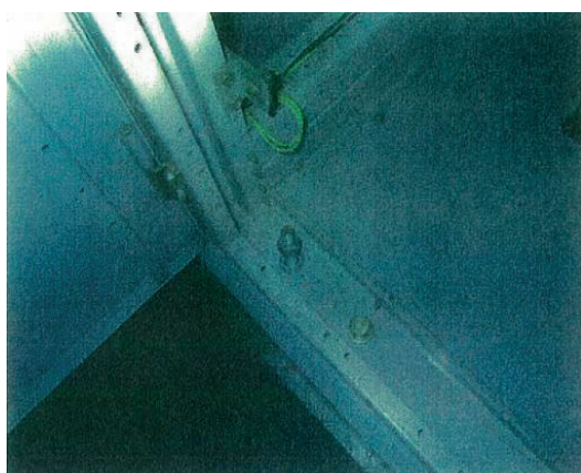
配電盤のアンカーボルト抜け出し （盤2面で8本）
