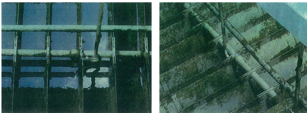
傾斜板装置、フックボルトのはずれ（中央） 写真 4.104 麓山浄水場被災状況（その2）
