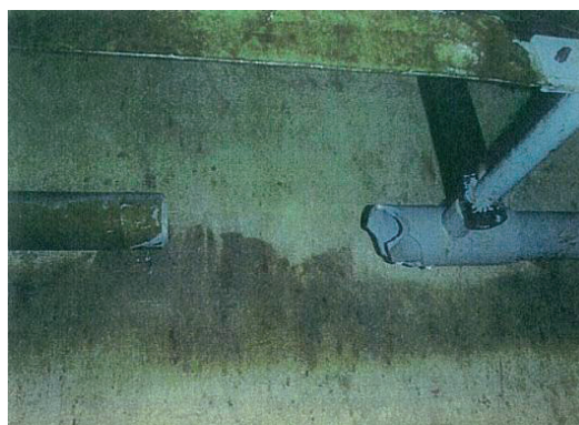
空気洗浄配管 (PVC 管) 折損
