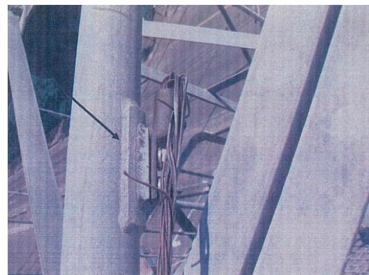
接地線の折損、ほつれ
