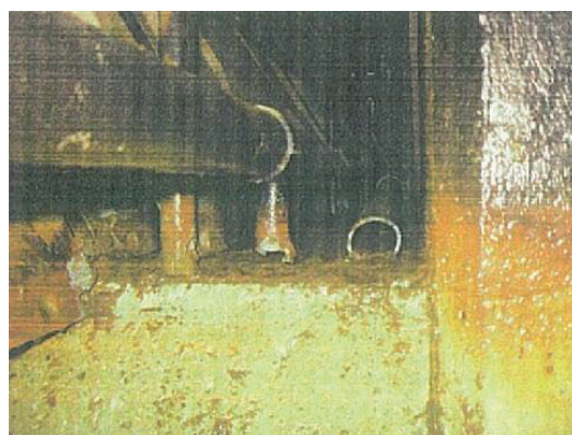
空気洗浄送気管の破損
