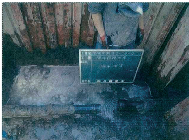
写真 2.14 ダクタイトイル鑄鉄管の継手部の離脱状況（千葉県浦安市）
