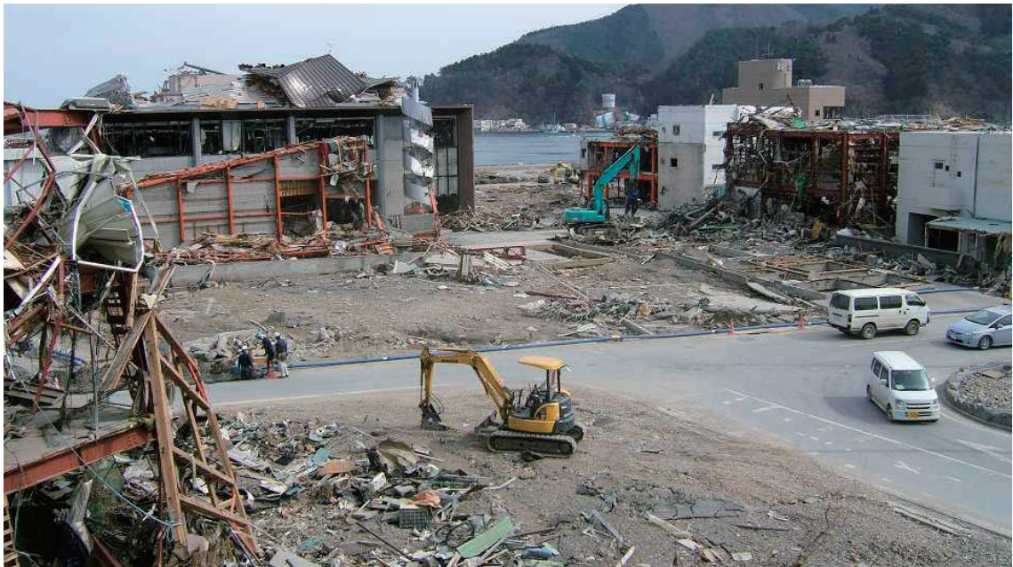
写真 2.13 震災直後の仮設配管の状況（宮城県女川町）
