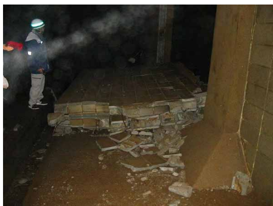
写真 3.1 整流壁の損壊例（宮城県仙台市水道局安養寺配水所）
