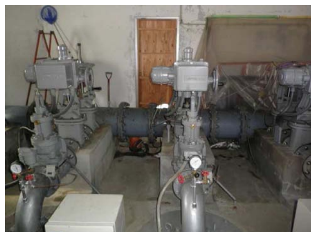
■ 取水ポンプ室の浸水跡（天井部）
