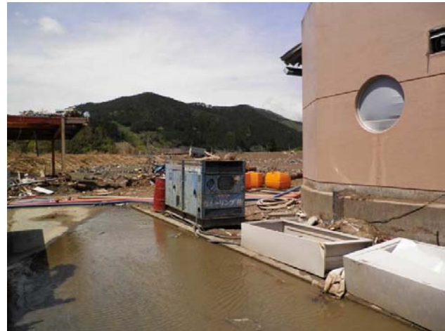
■ 自家発電設備
