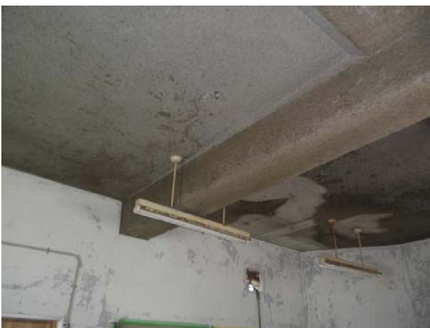
■ 取水ポンプ室の浸水跡（天井部）
