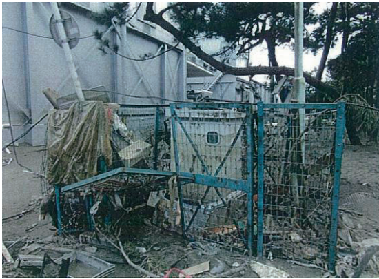
圧力計盤が津波で浸水した（全景）
