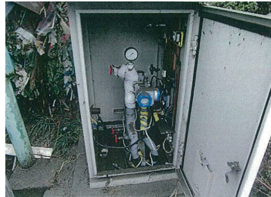
盤内部（表面側）
