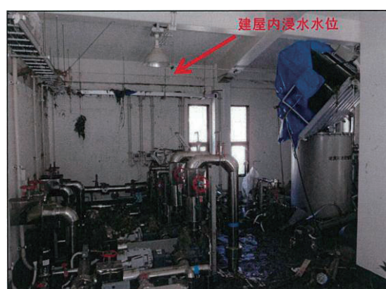
建屋内水没水位
