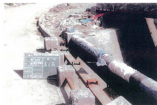
写真 4. 69 水管橋被災状況（空気弁の流出）
