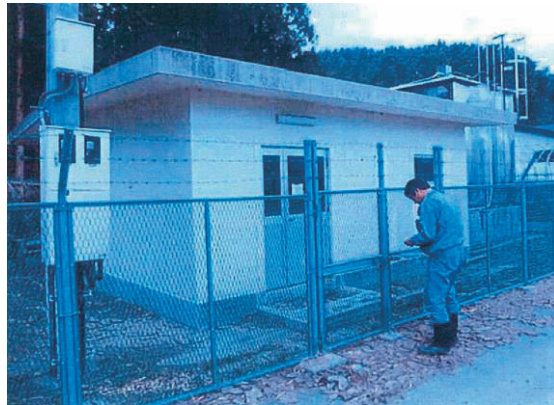
ポンプ場全景 津波で水没
