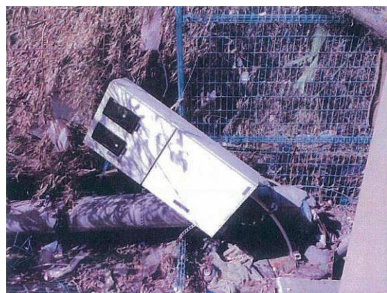
津波で倒壊・流失した引込開閉器盤
