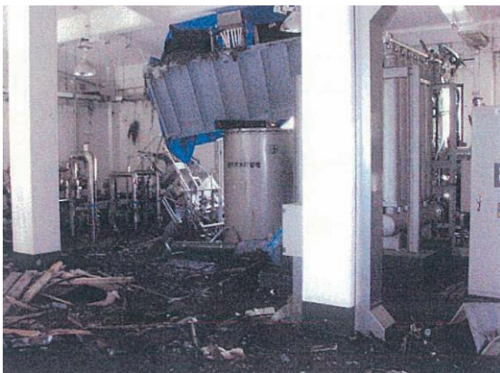
膜ろ過ユニット (右側)、津波破損
