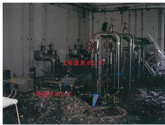
建屋内部の被災状況
