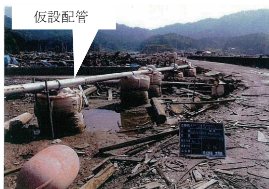
写真 4. 68 配水管津波被災状況
