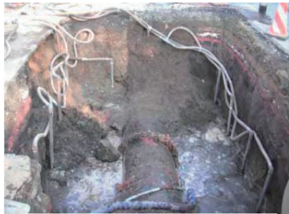
呼び径 600 DIP K形 継手漏水
