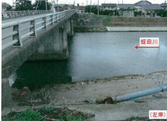
橋脚と共に配水管流出
