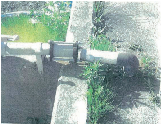
汚泥移送管 (VP 75A) は地震動で破損した
