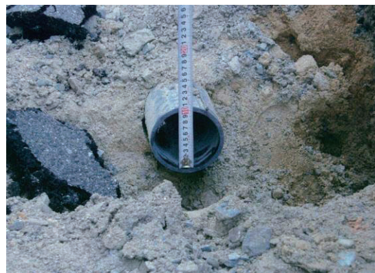
久之浜地区配水管被害
