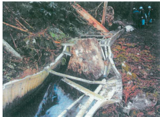
導水用開水路の損壊
