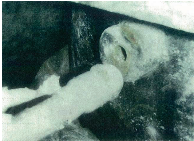
非常用貯水槽の空気抜管取り出し部（SGP 15A）折損
