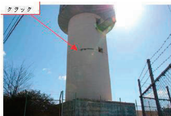
■八幡小路高架タンク 被害状況
