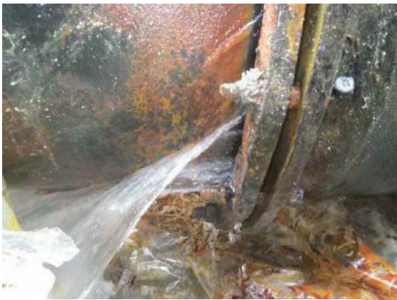
呼び径 600 DIP K形 継手漏水
