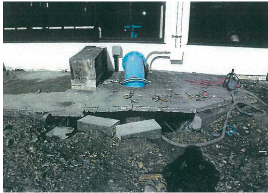
建屋～埋設管部（沈下）
