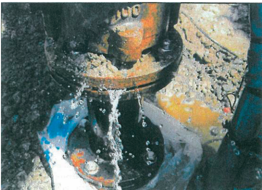
空気弁フランジ部漏水（例）
