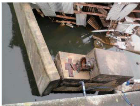
■小名浜地区 水管橋の津波被害
