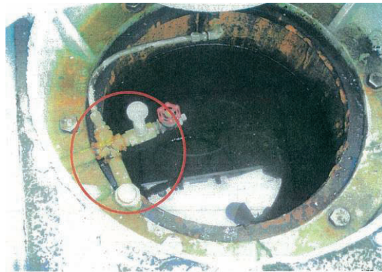
1系濃縮槽掻寄機 給油管 (SGP 25A ねじ込み式) は地震動で破損した
