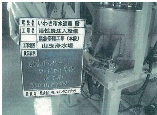
計量ホッパーロードセルが地震動で破損した
