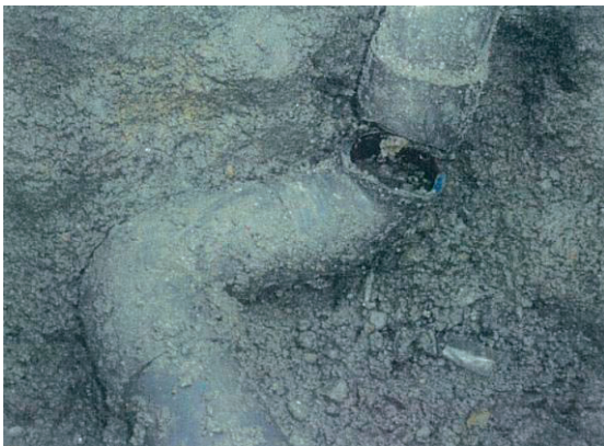
1系ろ過池 給水管 (HIVP 75A) は地震動で破損した
