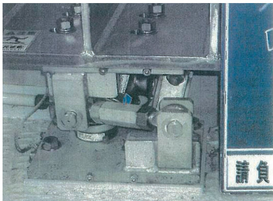
活性炭貯蔵槽ロードセルが地震動で破損した
