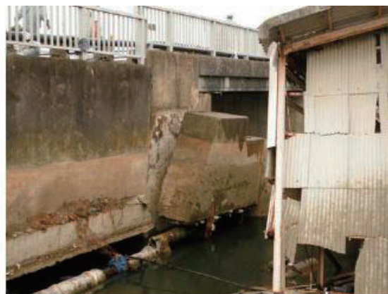
■小名浜地区 水管橋の津波被害
