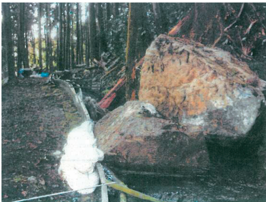
導水用開水路に落石
