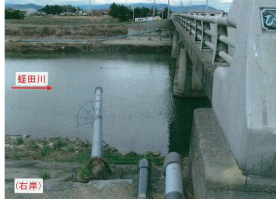
橋台付近での配水管切断流出
