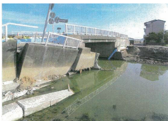
橋梁部配水管損傷（流出）
