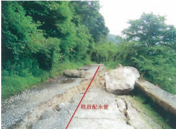
写真 4.10 併用林道(配水管埋設)被災状況 (花山温湯簡易水道 赤いラインが既設配管)
