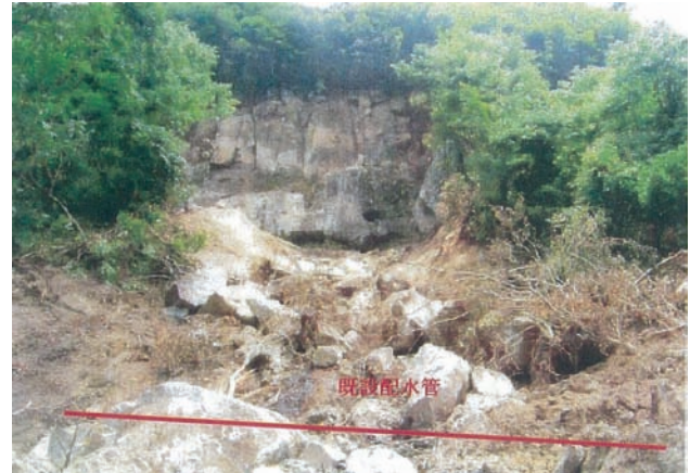
写真 4.11 岩盤崩落 既設配水管不明 (花山温湯簡易水道 赤いラインが既設配管)
