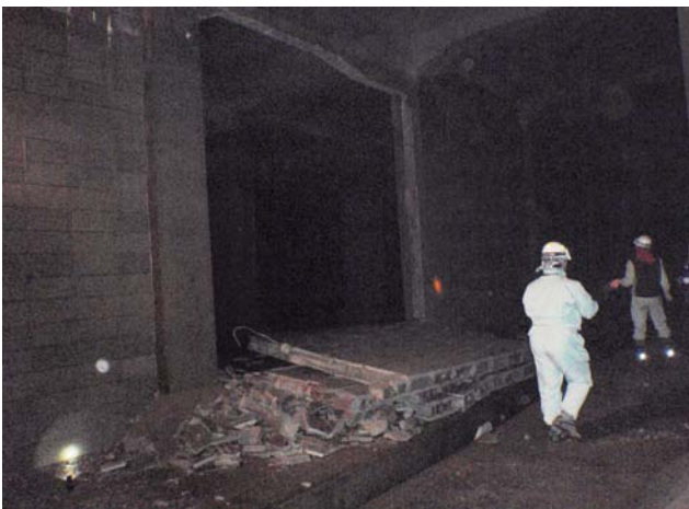
■安養寺配水所 池内導流壁一部倒壊
