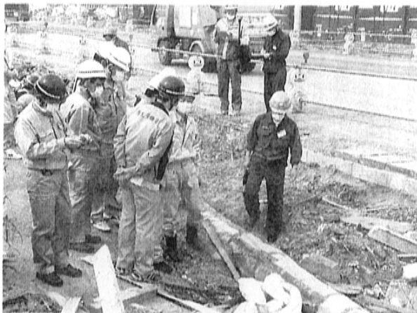
φ300NS形管からの漏水はなし
