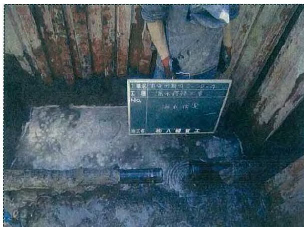
写真 3.8 ダクタイトイル鑄鉄管の継手部の離脱状況（千葉県浦安市）
