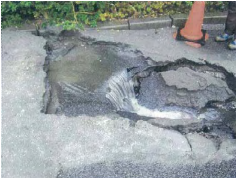
写真 3.12 液状化被害の状況(千葉県浦安市)
