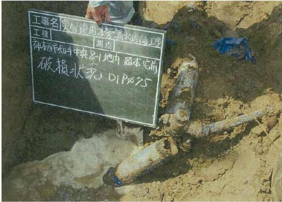
写真 3.13 サドル分水栓破損状況（茨城県神栖市）
