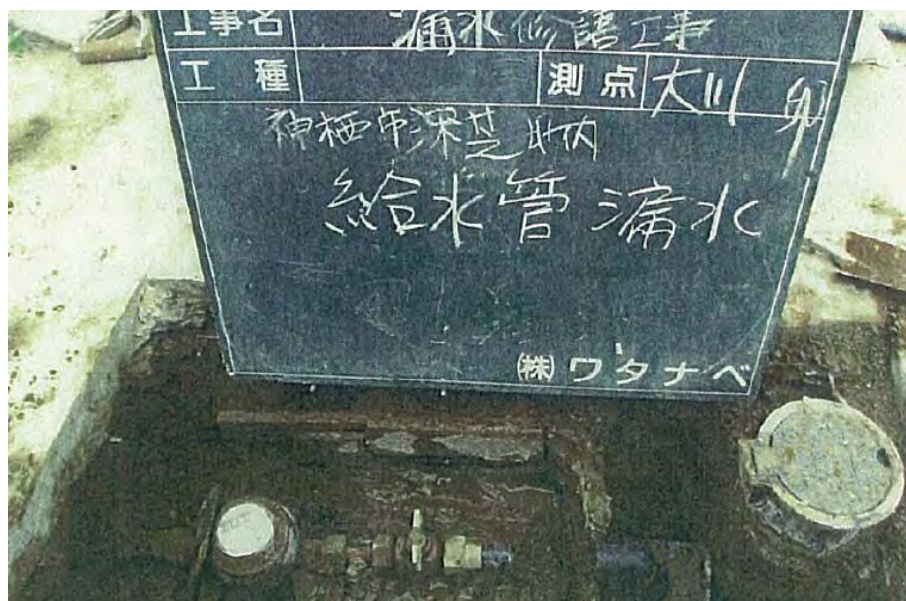
写真 3.14 給水メーター回り破損状況（茨城県神栖市）
