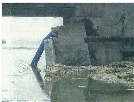
写真 3.16 水管橋(橋梁添架管)の被害状況 (福島県いわき市)
