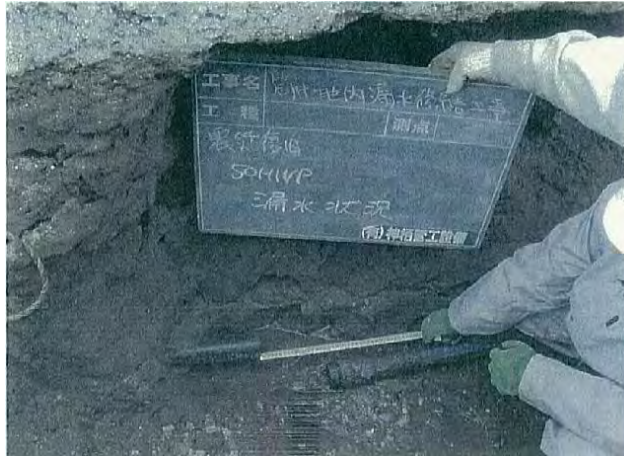
写真 3.9 硬質塩化ビニル管の被害状況（茨城県神栖町）
