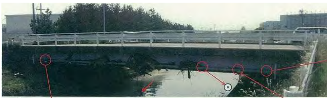
写真 3.15 水管橋(橋梁添架管)の被害状況 (宮城県岩沼市)
