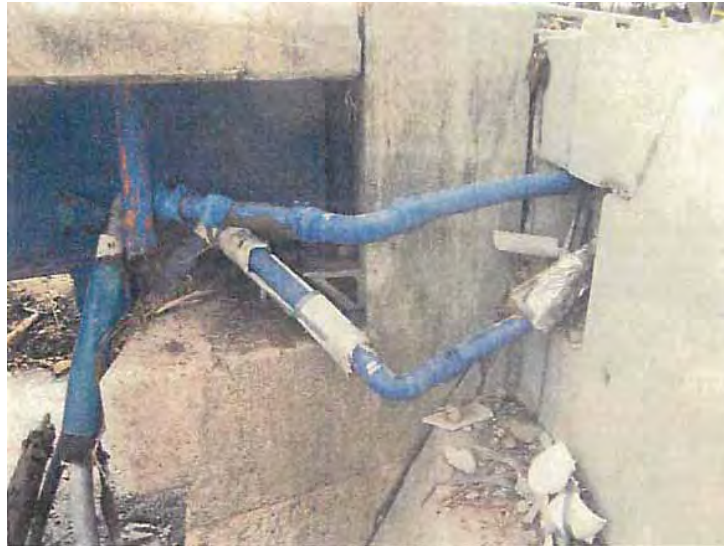
写真 3.10 EF 接合管被災部（左側が水管橋流出部）
