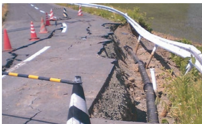
写真 4.3 DIP200 (K形) の被害状況 (継手漏水)
