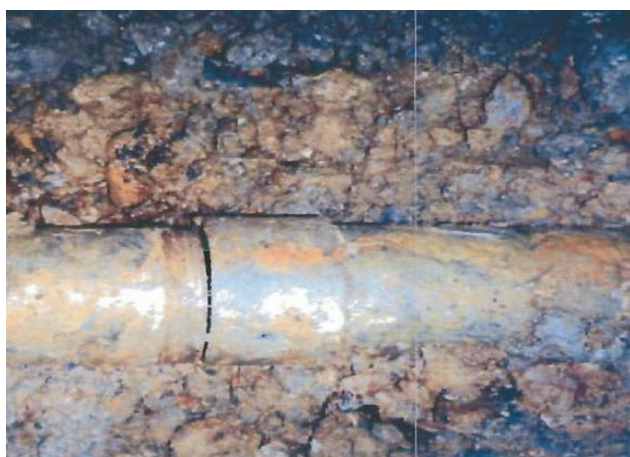
写真 4.1 SP150 (ネジ継手) の被害状況 (継手漏水)
