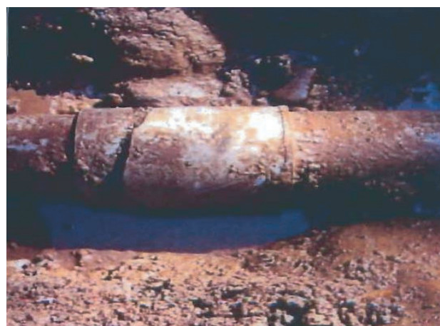
写真 4.2 VP150 (TS継手) の被害状況 (継手漏水)
