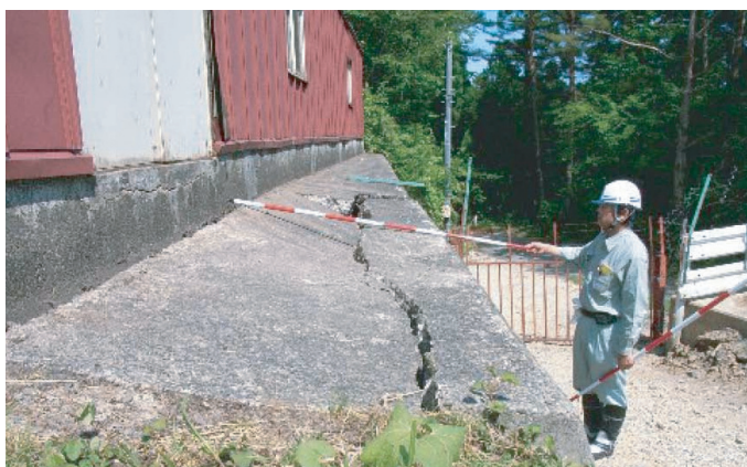
写真5.1 北股浄水場被災状況
