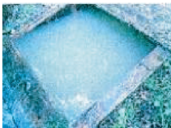
写真5.2 衣川簡易水道鳴沢水源高濁度状況
