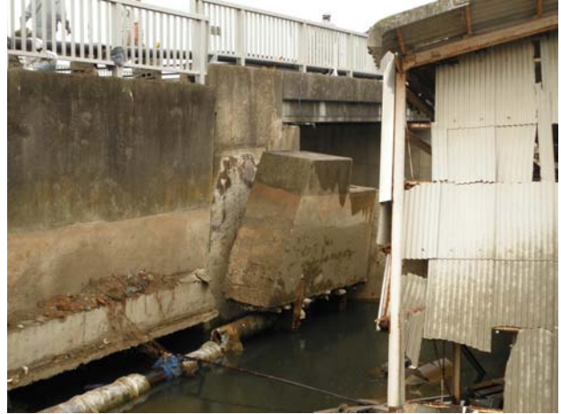
■小名浜地区 水管橋の津波被害
