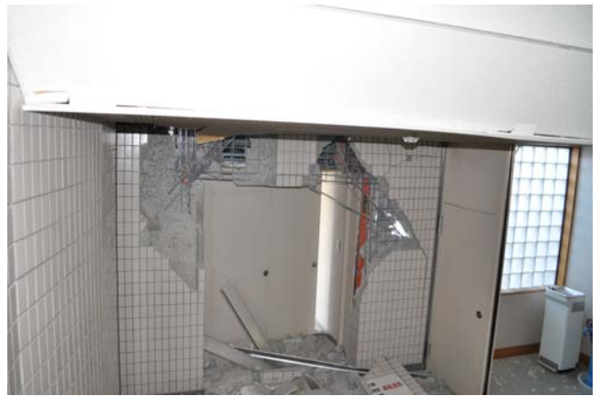
■水道局庁舎 開口部周囲の雑壁破損
