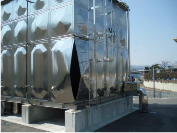
■新池下増圧ポンプ場 受水槽破損 容量 160 m 3
