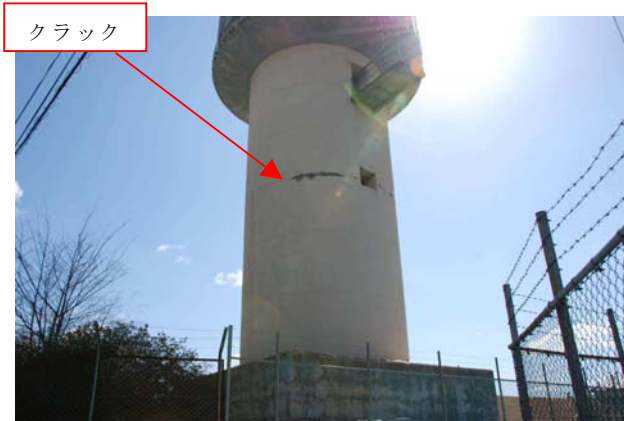
■八幡小路高架タンク 被害状況
