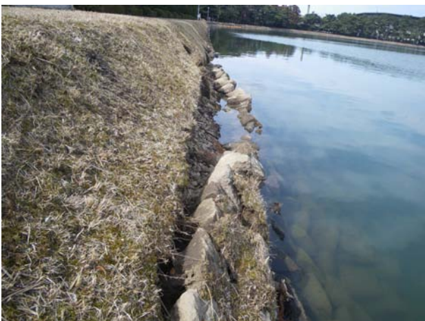
■豊田浄水場 貯水池石垣の崩れ
