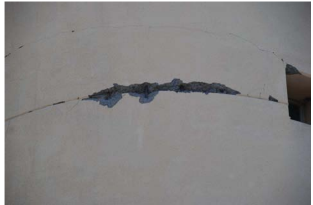
■八幡小路高架タンク クラック部拡大
