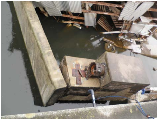
■小名浜地区 水管橋の津波被害
