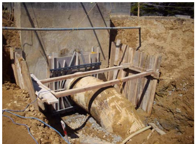
■堀口浄水場 急速混和池流出管漏水
