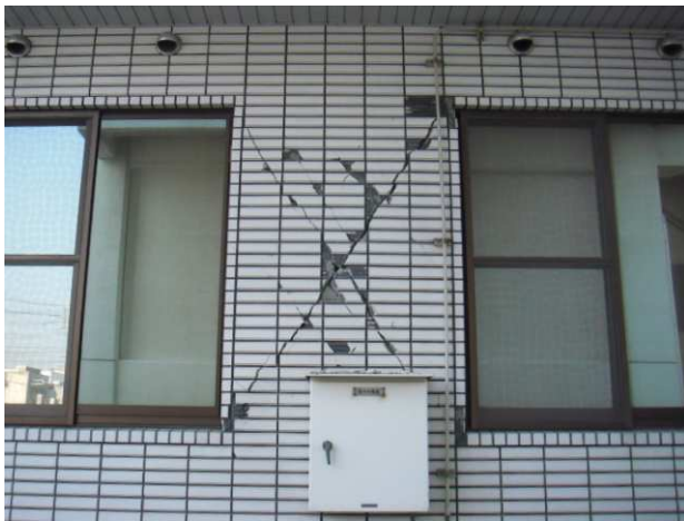
■水道局庁舎 壁の破損
