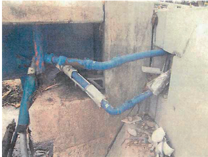
写真 2.16 EF 接合管被災部（左側が水管橋流出部）
