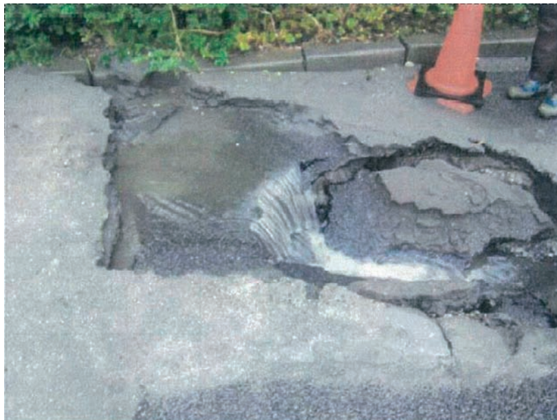
写真 2.18 液状化被害の状況(千葉県浦安市)
