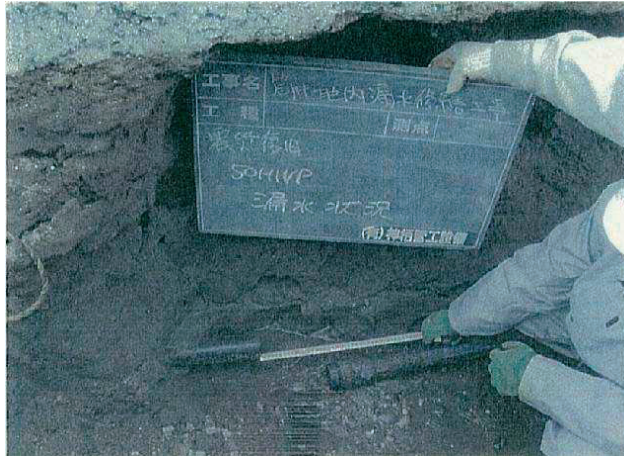
写真 2.15 硬質塩化ビニル管の被害状況（茨城県神栖町）
