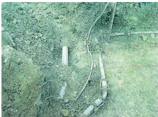
反町配水池場内配管被害
