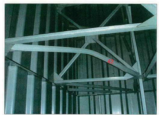
水槽内 斜材の変形（複数あり）
