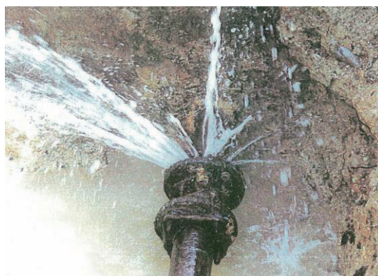
畑岡浄水場、φ100DIP 継手漏水
