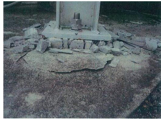
基礎コンクリートベース破損（4基分）
