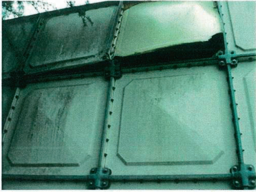
パネルが枠補強から離脱（複数あり）
