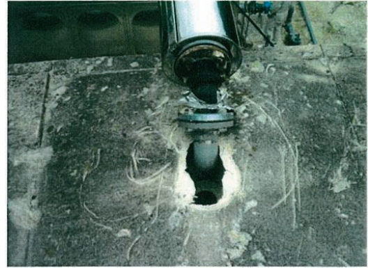
配管接続部パネル破損
