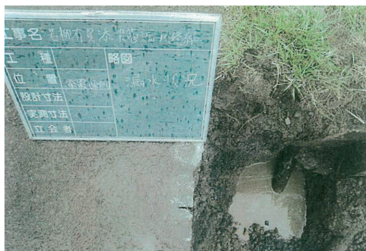
写真 4.93 水管橋添架管被災状況 (災害査定資料)
