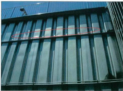
側板損傷（曲げ座屈による変形）
