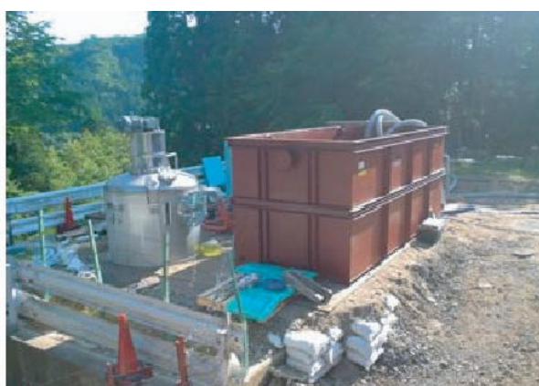
写真 5.4 北股簡易水道ろ過機設置状況
