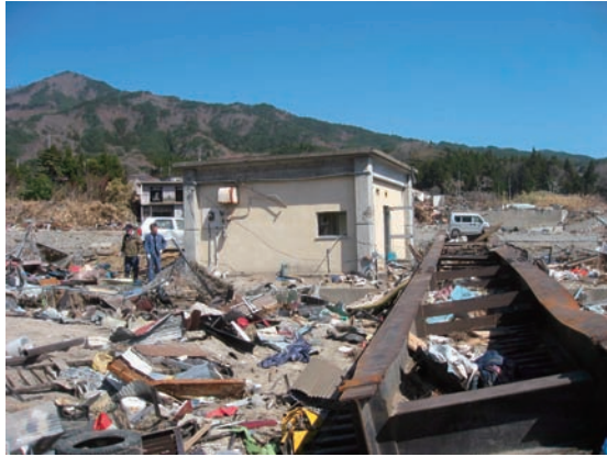
写真 2.10 津波による加圧ポンプ所の被災例（岩手県大槌町浪板ポンプ場）
