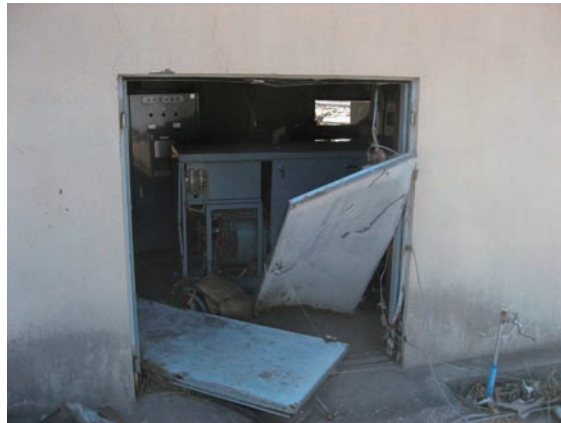
写真 2.11 津波による建具損壊状況（岩手県大槌町浪板ポンプ場）
