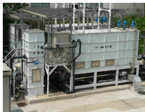
浄水処理実習プラント
