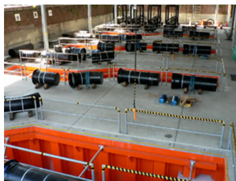
大口径配管実技場
