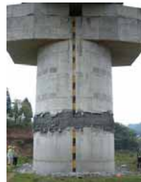
写真 2.1 新幹線橋脚被害
