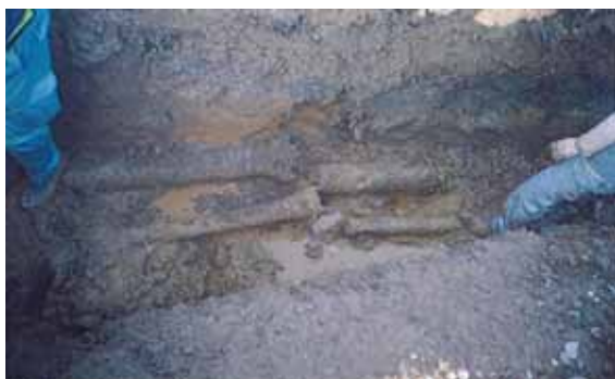
写真 5.4 150, 75 ダクタイトイル鉄管 (A形) 継手抜け
