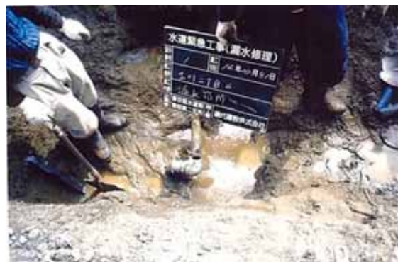
写真 5.5 50 鋼管ねじ継手破断
