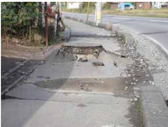
写真 5.2 管路被害が多発した 道路状況(長岡市柿町)
