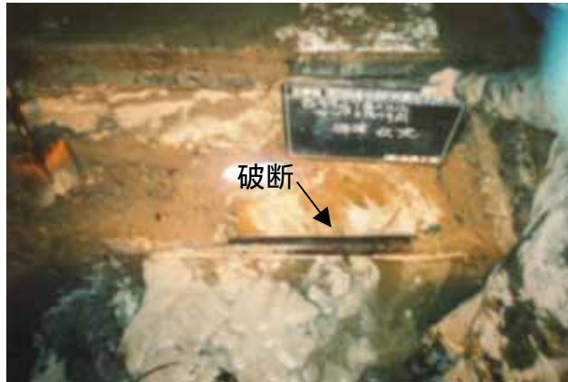
写真 5.1 呼び径 75 鋳鉄管の破断状況例(長岡市内)
