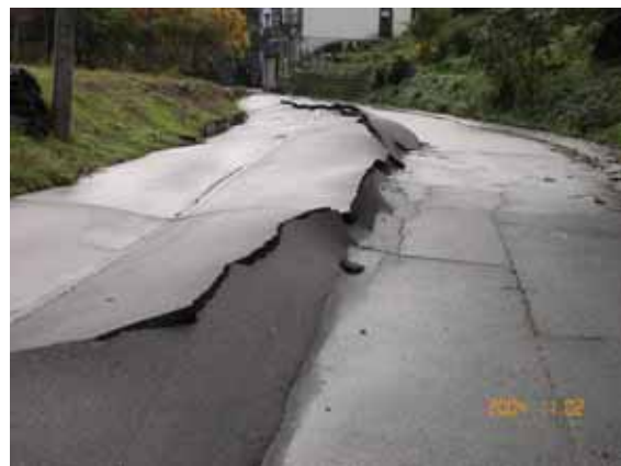
写真 5.3 亀裂が多発した道路状況 (長岡市栖吉町)
