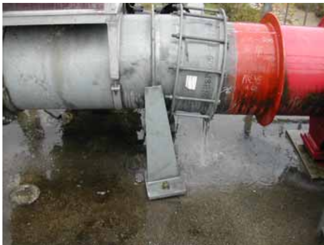
写真 4.16 伸縮管（リーブタイプ）とリングサポートの変形
