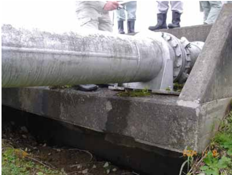
写真 4.6 場内の水管橋支承固定 部のうきあがり
