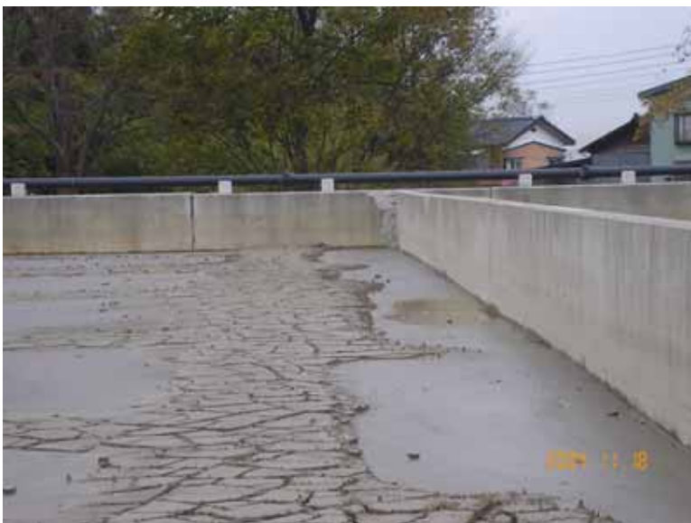
写真 4.7 天日乾燥床壁面・構造目 地（珪砂・ソコゾク・ポイント） の損傷
