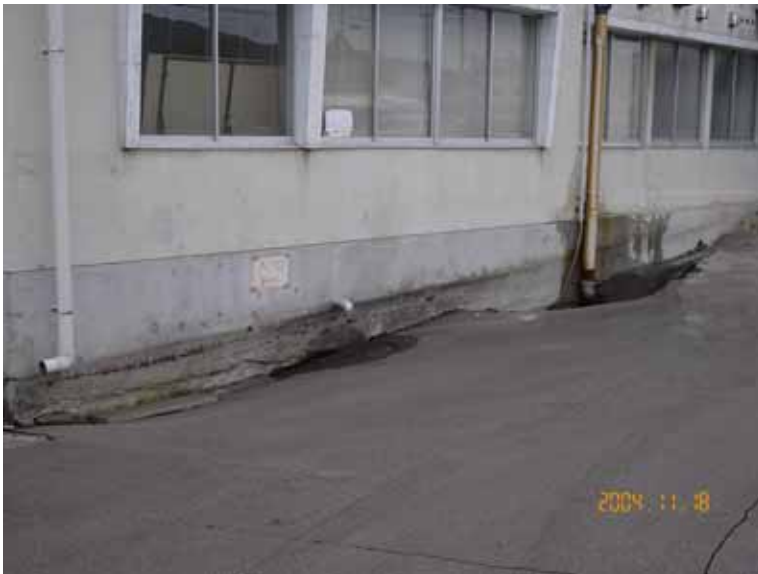
写真 4.2 管理棟周辺の沈下状況
