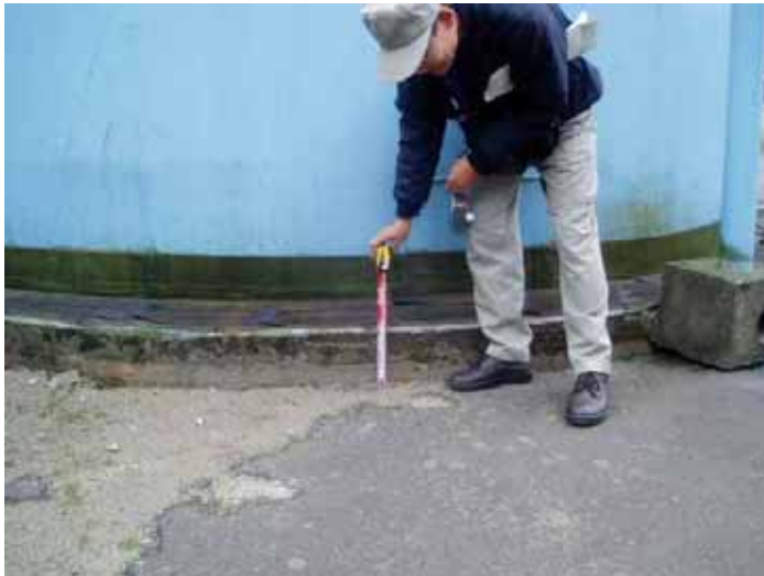
写真 4.10 • ろ過池廻りの地盤沈下 • 浄水場地盤が全体的に20cm 程度沈下が見られた
