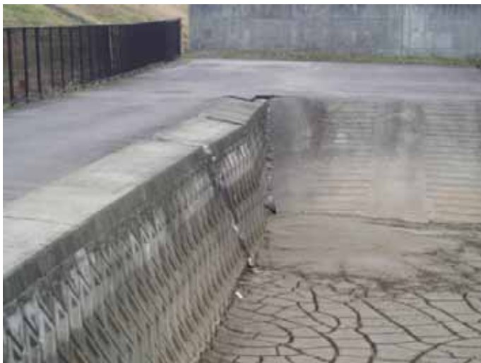
写真 4.11 排泥池のクラック
