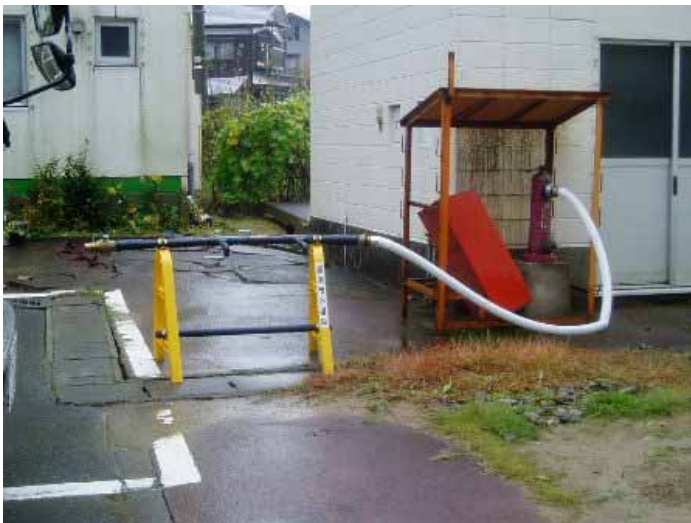
写真 3.3 川口町における仮設給水栓
