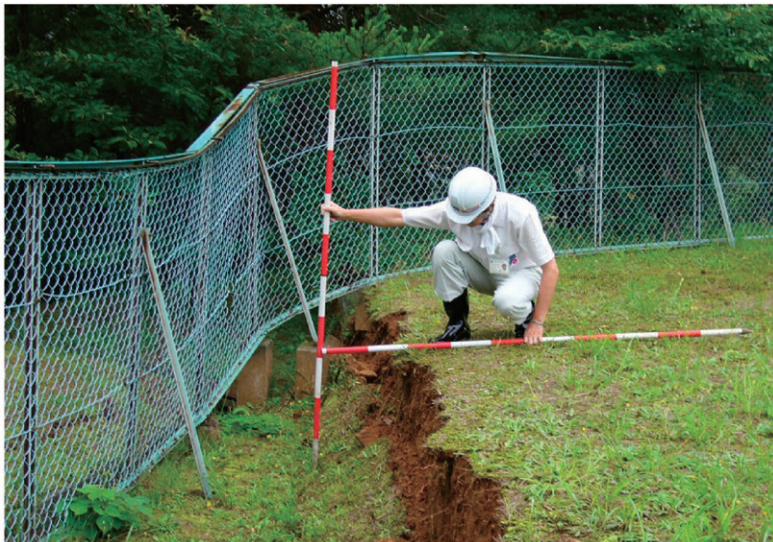
写真 5.5 赤坂山浄水場配水池周り沈下及び亀裂発生状況
