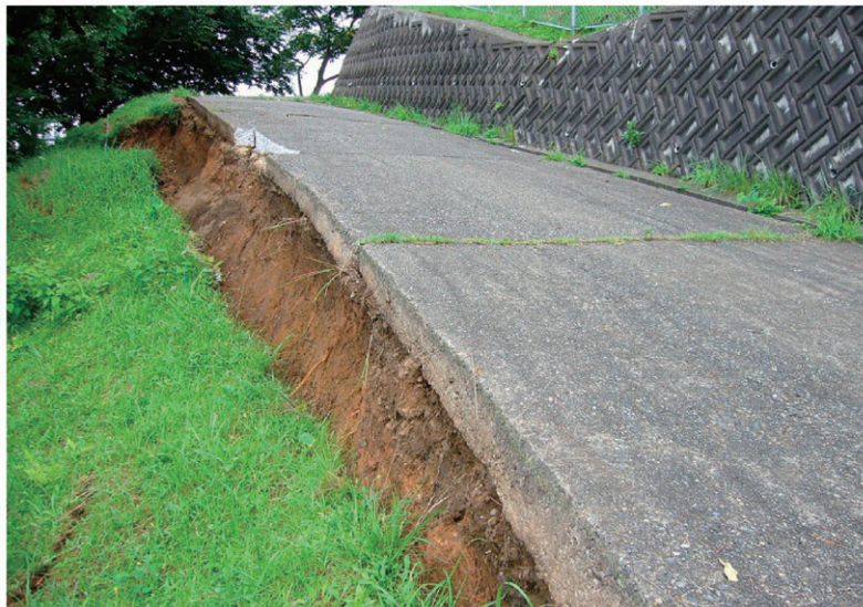
写真 5.6 岬町配水場場内道路及び亀裂発生状況
