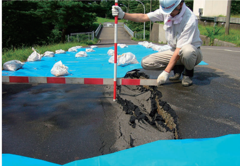
写真 5.4 赤坂山浄水場場内道路陥没及び亀裂発生状況
