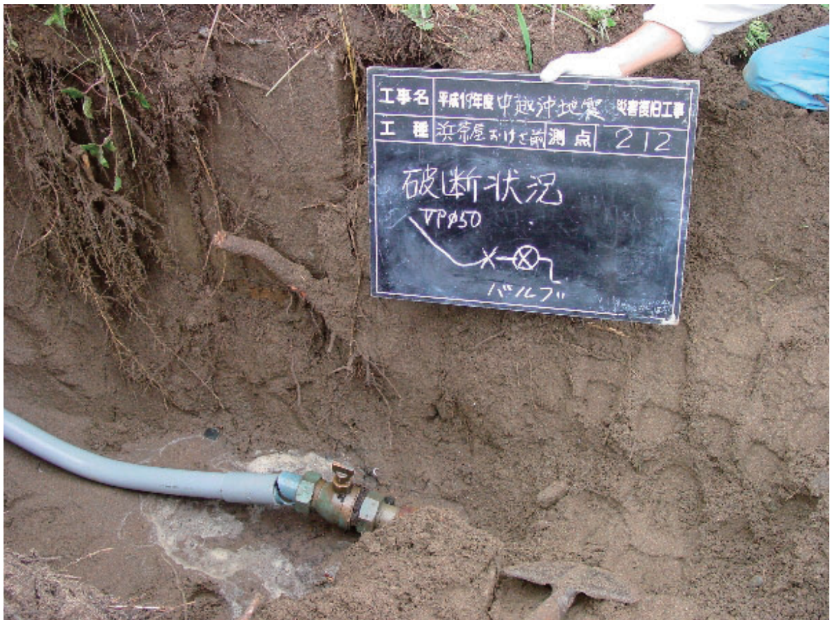
写真 4.2 呼び径 50 硬質塩化ビニル管の管体破損
