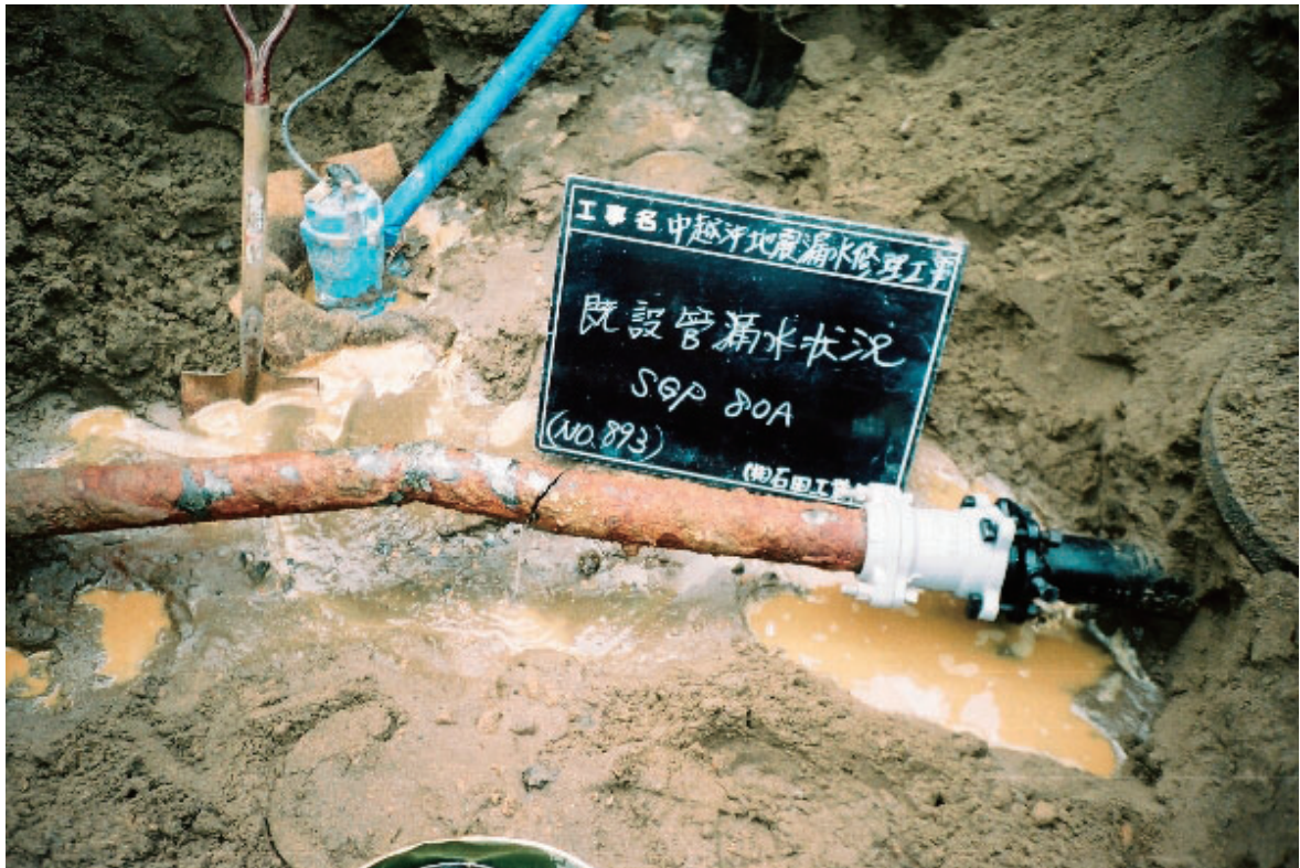
写真 4.1 呼び径 80 鋼管（ネジ継手）の管体破損
