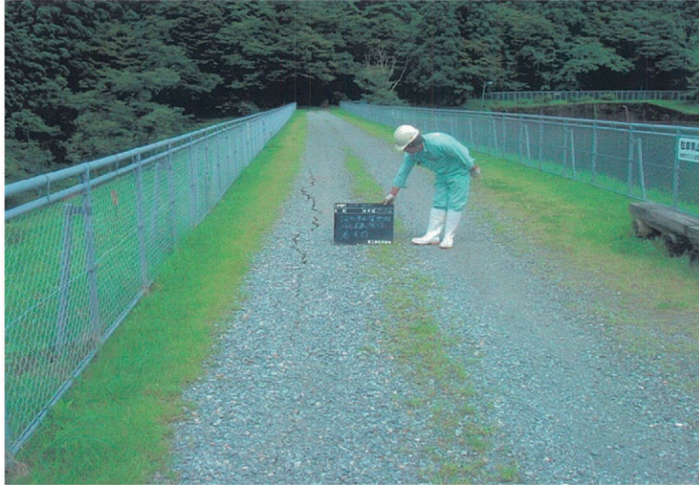
写真 5.1 川内ダム天端の亀裂発生状況
