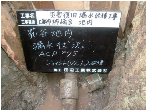
写真 4.7 呼び径 75 ACP ソケット破損
