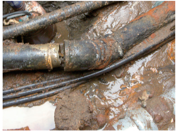
写真 4.8 呼び径 75 SGP ネジ継手破損
