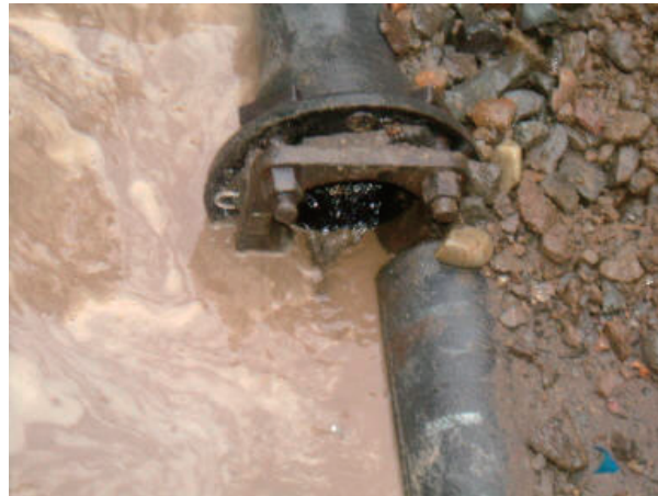
写真 4.9 呼び径 100 DIP A形継手抜け
