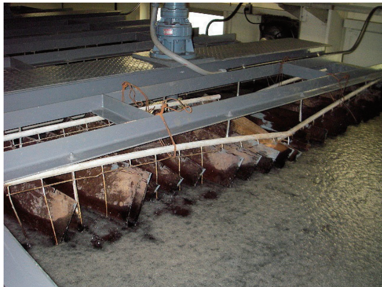
写真 5.9 西浦浄水場沈澱槽傾斜板破損状況
