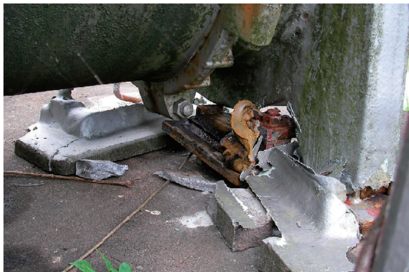
写真 5.14 橋台支承部の損傷状況
