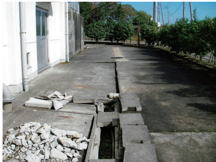
写真 5.10 刈羽第二水源浄水場場内舗装・側溝沈下及び亀裂発生状況
