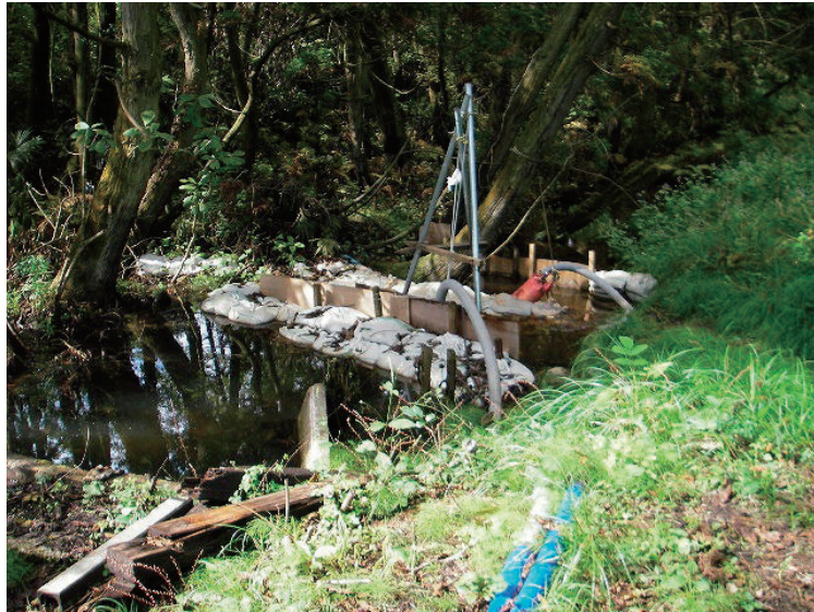
写真 5.8 刈羽第二水源浄水場溜付水源破損状況
