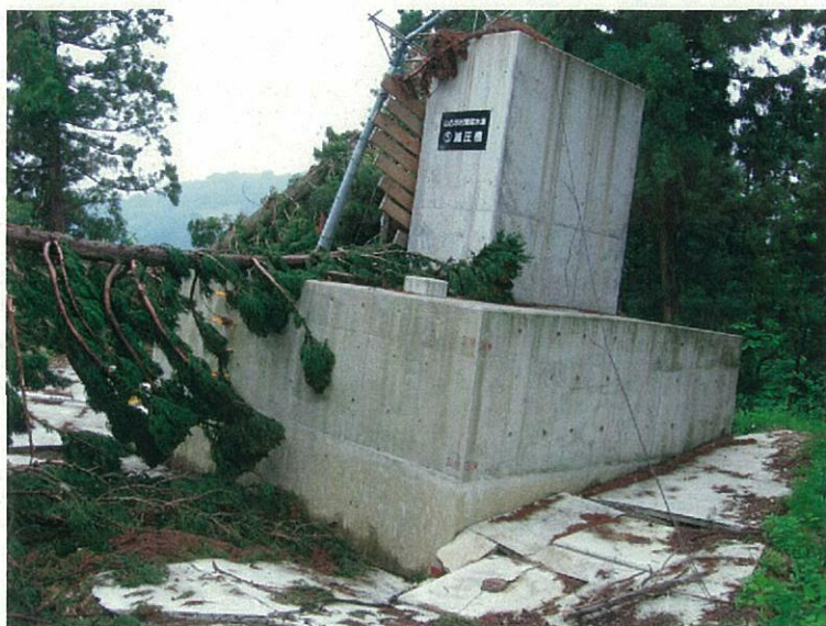
写真 5. 4 傾斜した⑤減圧槽
