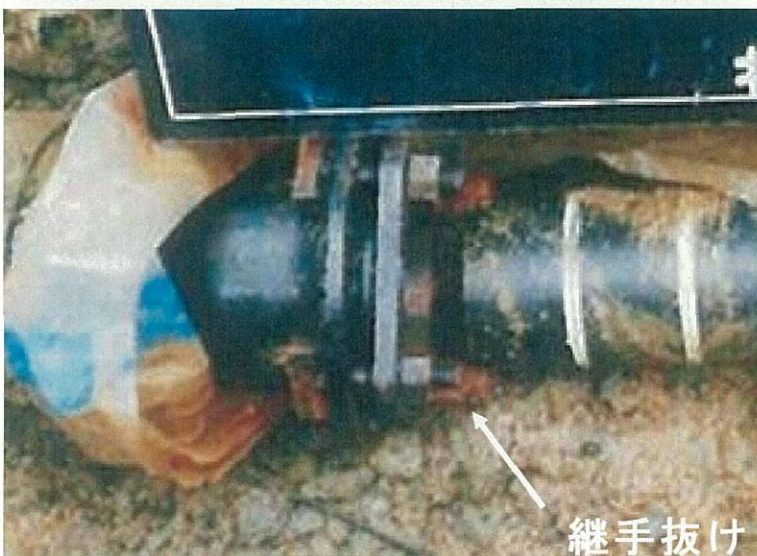
写真 5.14 K形ダクタイトイル鉄管の被害 状況（継手抜け）
