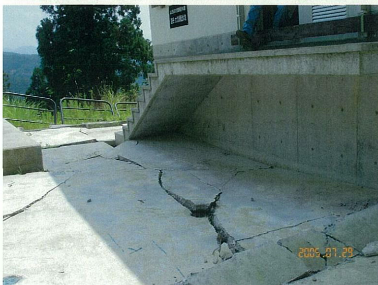
写真 5.3 傾斜した池谷・大久保配 水池（階段廻り）
