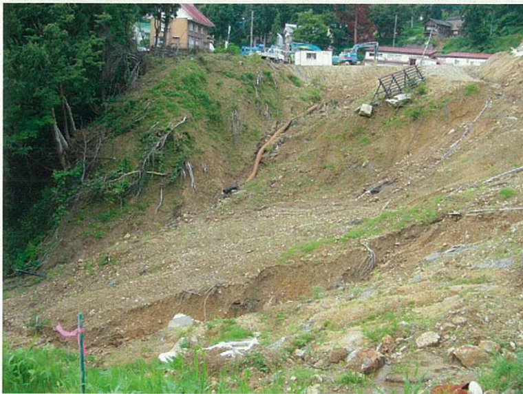
写真 5.8 第2送水ラインにおける 道路崩壊状況
