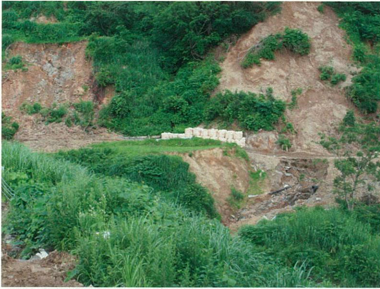
写真 5.7 第1送水ラインにおける 道路崩壊状況
