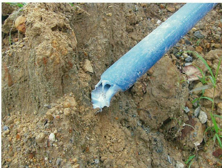
写真 5.17 配水用ポリエチレン管の被害状況（管体破断）
