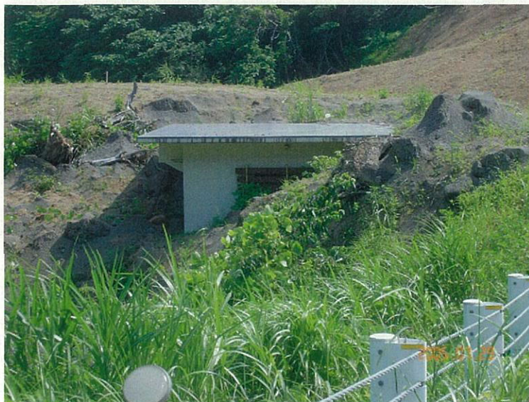
写真 5.1 土砂崩落により埋没した 第1中継ポンプ場
