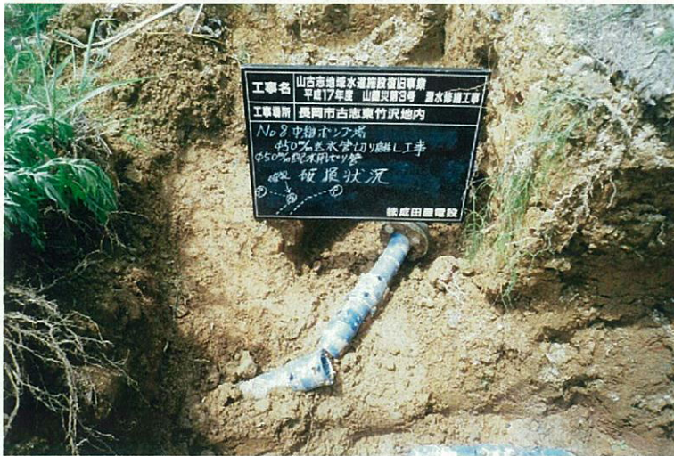
写真 5.15 配水用ポリエチレン管の被害状況（融着継手部破断）
