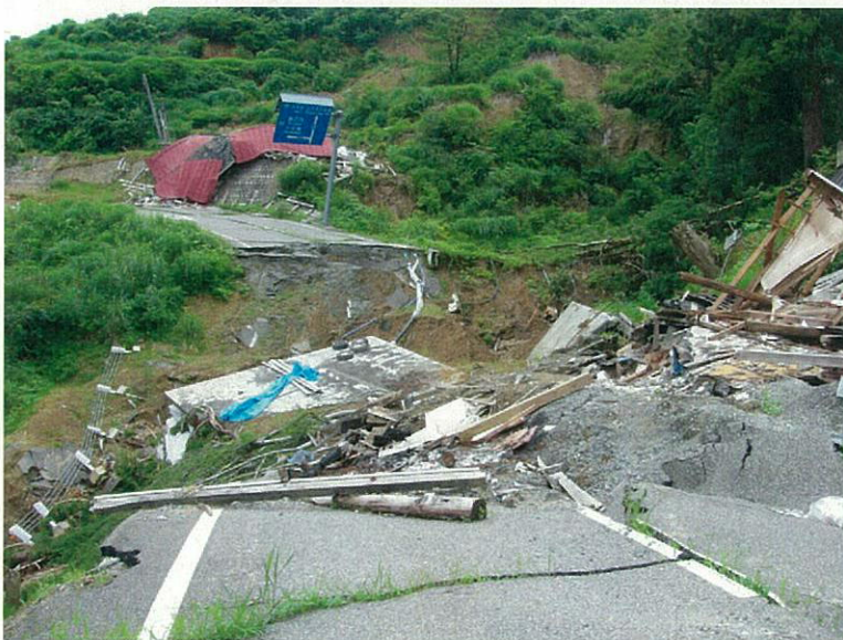
写真 5.9 第5送水ライン及び池 谷・大久保配水区配水管に おける道路崩壊状況
