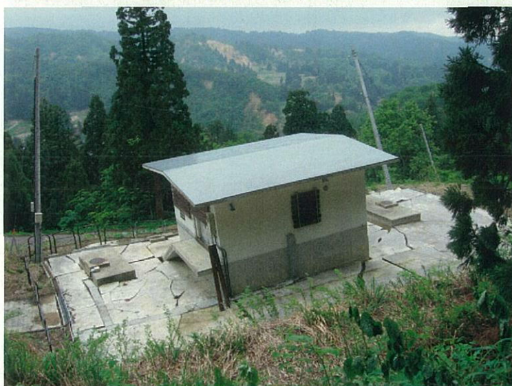
写真 5.2 傾斜した池谷・大久保配 水池（全景）
