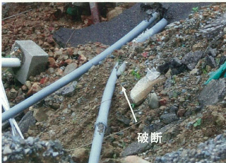
写真 5.18 R R 継手硬質塩化ビニル管 の被害状況（管体破断）
