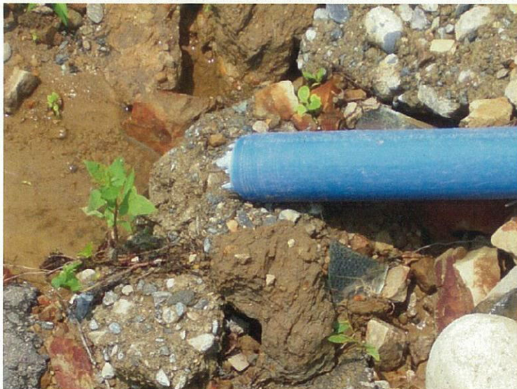
写真 5.16 配水用ポリエチレン管の被害状況（融着継手部破断）
