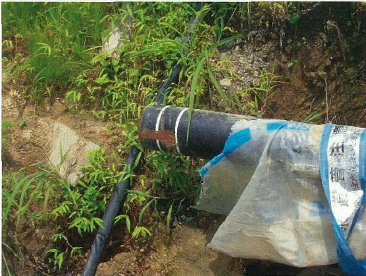
写真 5.13 K形ダクタイトイル鉄管の被害 状況（継手抜け）
