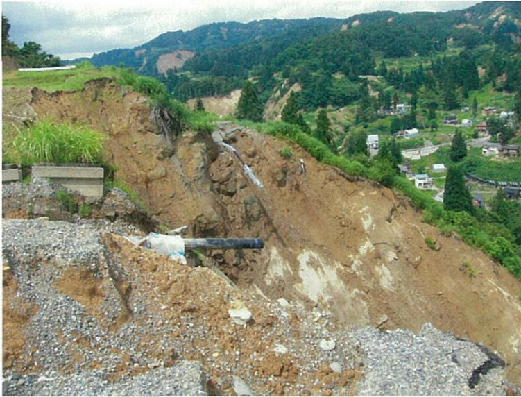
写真 5.12 K形ダクタイトイル鉄管の被害 状況（継手抜け）
