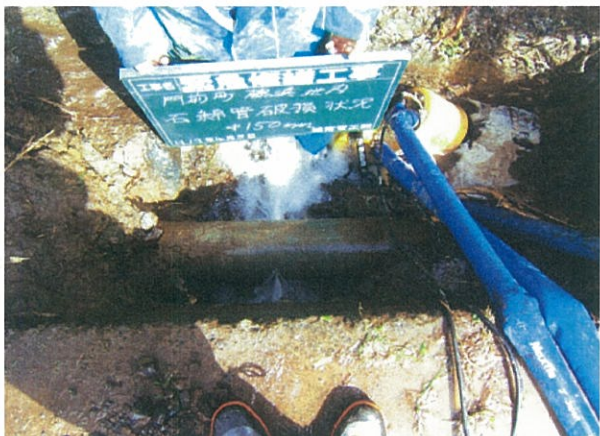
写真 4.1 呼び径 150 ACP 管体破損
