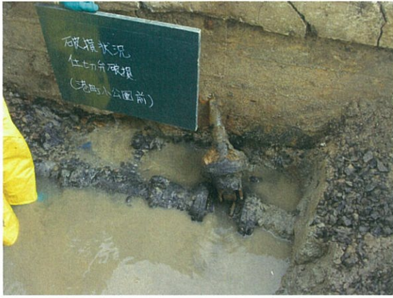
写真 4.5 仕切弁本体の破損
