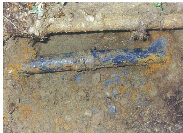
写真 4.2 呼び径 65 SGP ネジ継手破損
