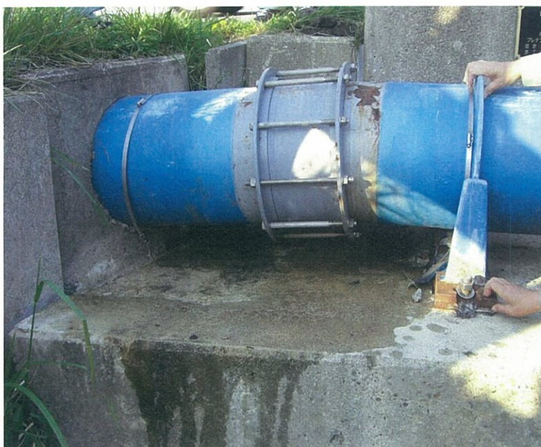
写真 5.12 水管橋伸縮管の損傷状況
