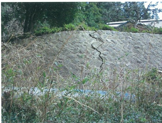
①擁壁の亀裂 (幅 5~10cm)
