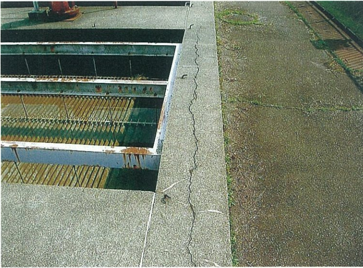
写真 5.10 上野浄水場沈殿池 クラック
