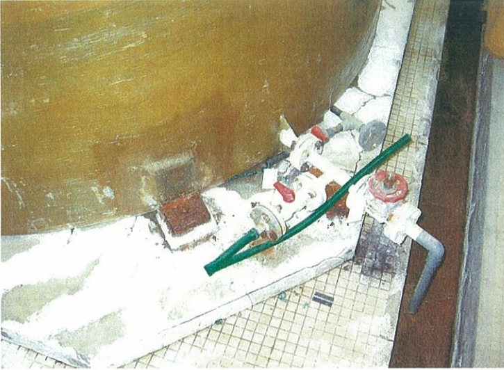
写真 5.9 上野浄水場次亜塩素 タンク損傷状況
