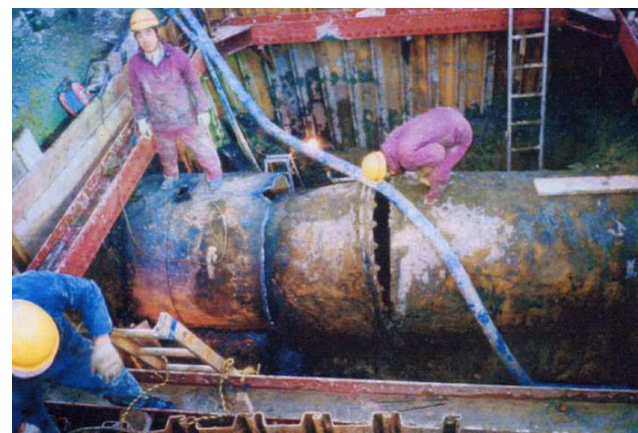
地震によって破損した管路(阪神水道)
