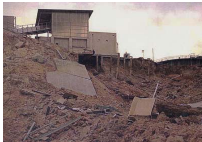
のり面崩壊が発生した甲山浄水場(阪神水道)
