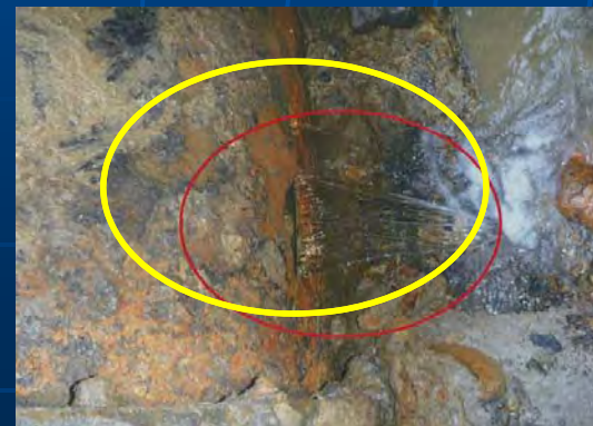
老朽管の被害
