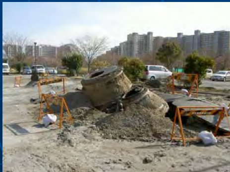
液状化による被害
