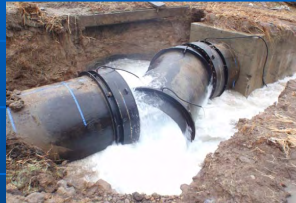
基幹管路の断水
