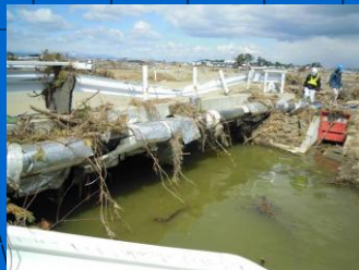
DIP NS形φ350 橋梁添架管(被害なし)
