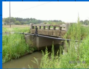
DIP 水管橋(被害なし:線形に変化あり)
