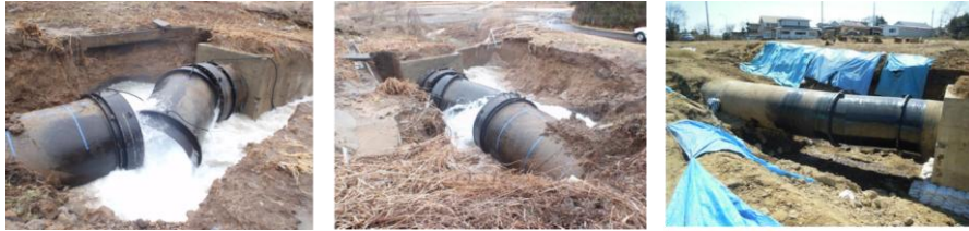
鋼管φ 2400可撓管の離脱と溶接による仮復旧(白石市内)
