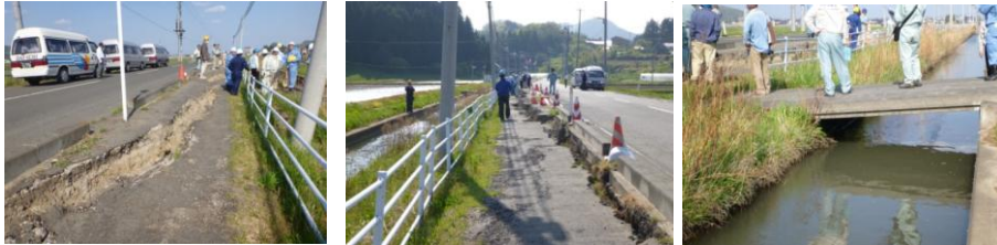
ダクタイル鉄管φ 900S形埋設現場の地盤変状(柴田町)
