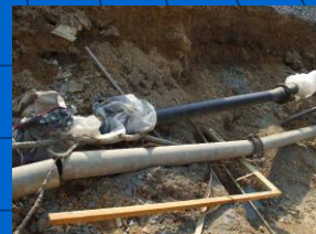
女川町φ100石綿セメント管の破損
