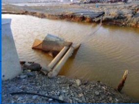
陸前高田町φ200ダクタイル鉄管の抜け
