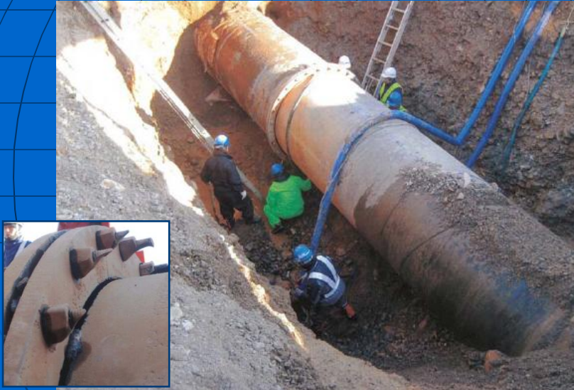
φ1500 ダクタイル鉄管 K形継手の離脱
