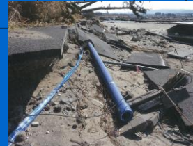
新地町ポリエチレン管の破損
