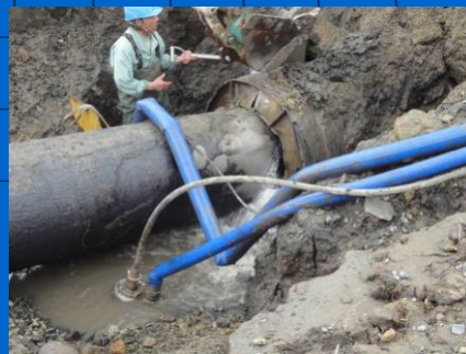
宮城県仙台市内 φ700 鋼管 継手部漏水
