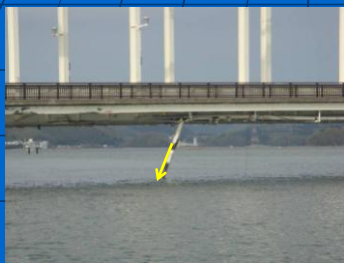
石巻港付近 鋼管φ200 津波被害
