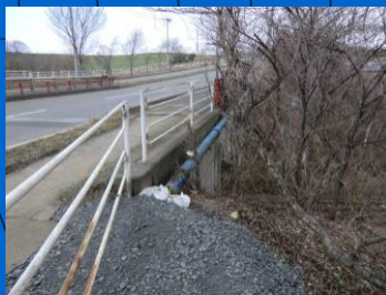
鋼管φ100水管橋抜け(余震被害)
