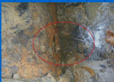
いわき市 φ1100 ダクタイル鉄管の腐食
