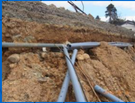
気仙沼市塩化ビニル管の破損
