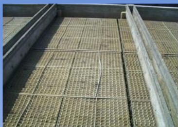
茂庭浄水場沈澱池傾斜版
