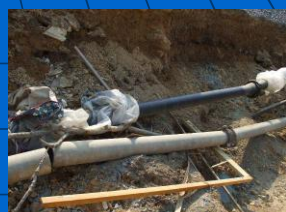
女川町φ100石綿セメント管の破損
