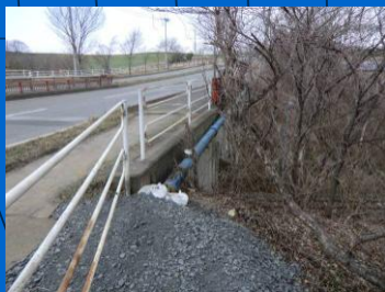
鋼管φ100水管橋抜け(余震被害)
