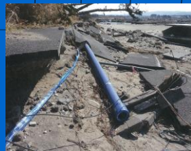
新地町ポリエチレン管の破損
